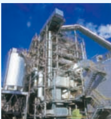
バイオマスボイラー（木質燃料ボイラー）
