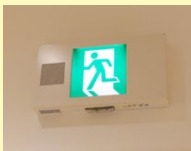
避難口誘導灯
