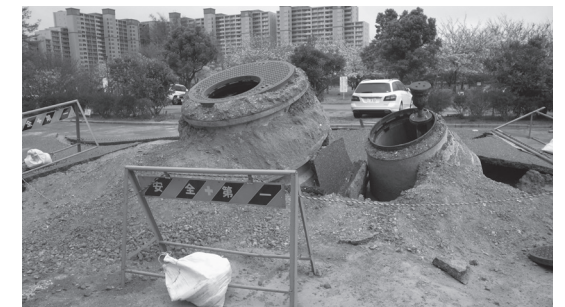
液状化現象によってうき上がったマンホール
