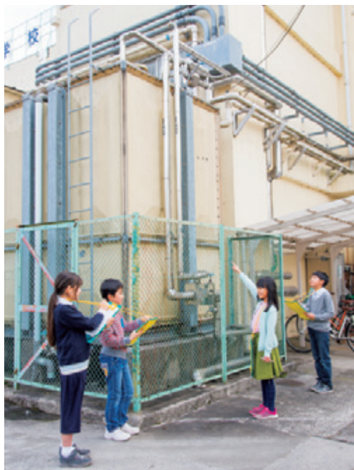
📍ア 学校の中にある水道管と 受水そう
