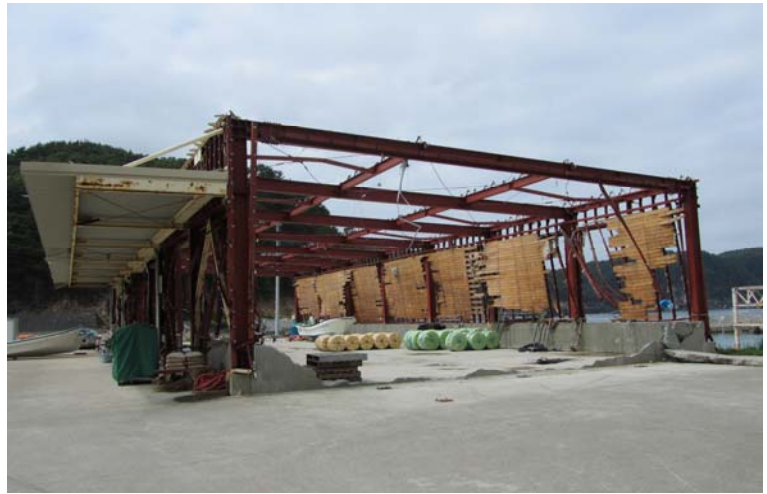
▲津波の被害を受けた、音部漁港の集荷場
